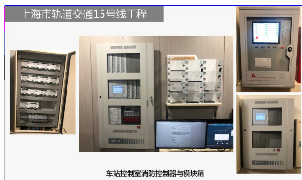
图3 15号线车控室火灾自动报警系统设备
